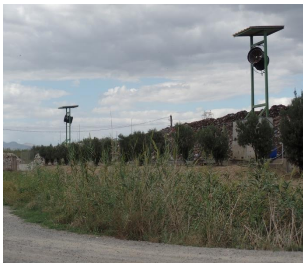
Obr. č. 4 – 2 ventilátory na straně kompostárny
