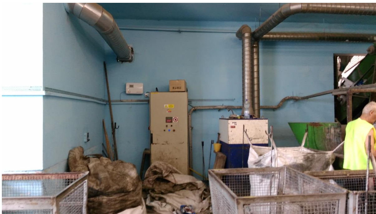
Umístění 2. zařízení AirForce® Plus FIVE v opačném rohu místnosti
