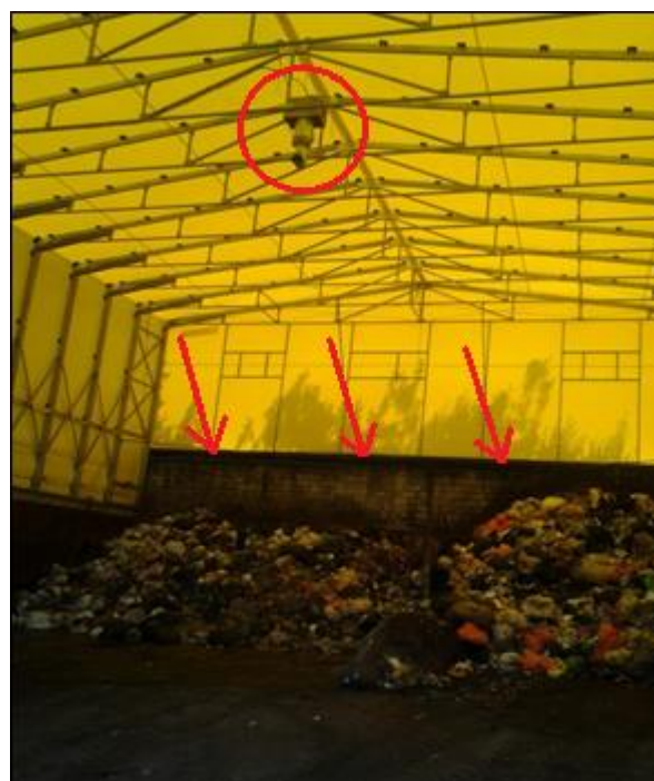
Zařízení Turbo a perforovaná hadice po obvodu stěny
