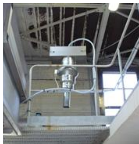
Zařízení Turbo v prostoru čerpací stanice
