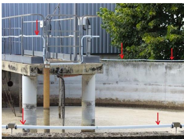
Perforovaná hadice po obvodu usazovací nádrže
