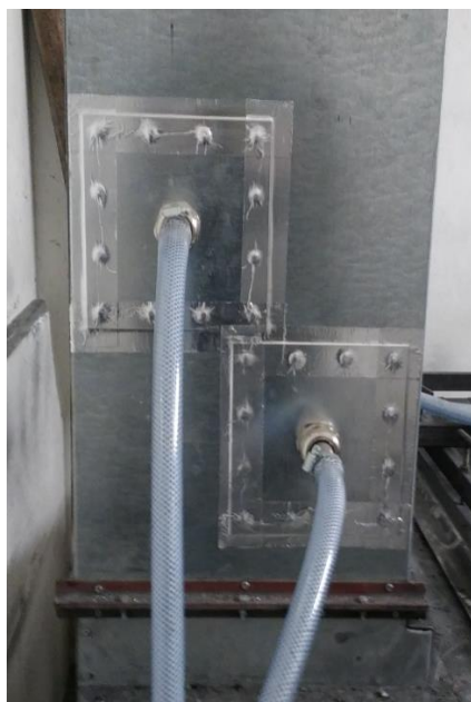
Vysokotlaké hadice napojené na 2 perforované trubice instalované do vzduchotechniky
