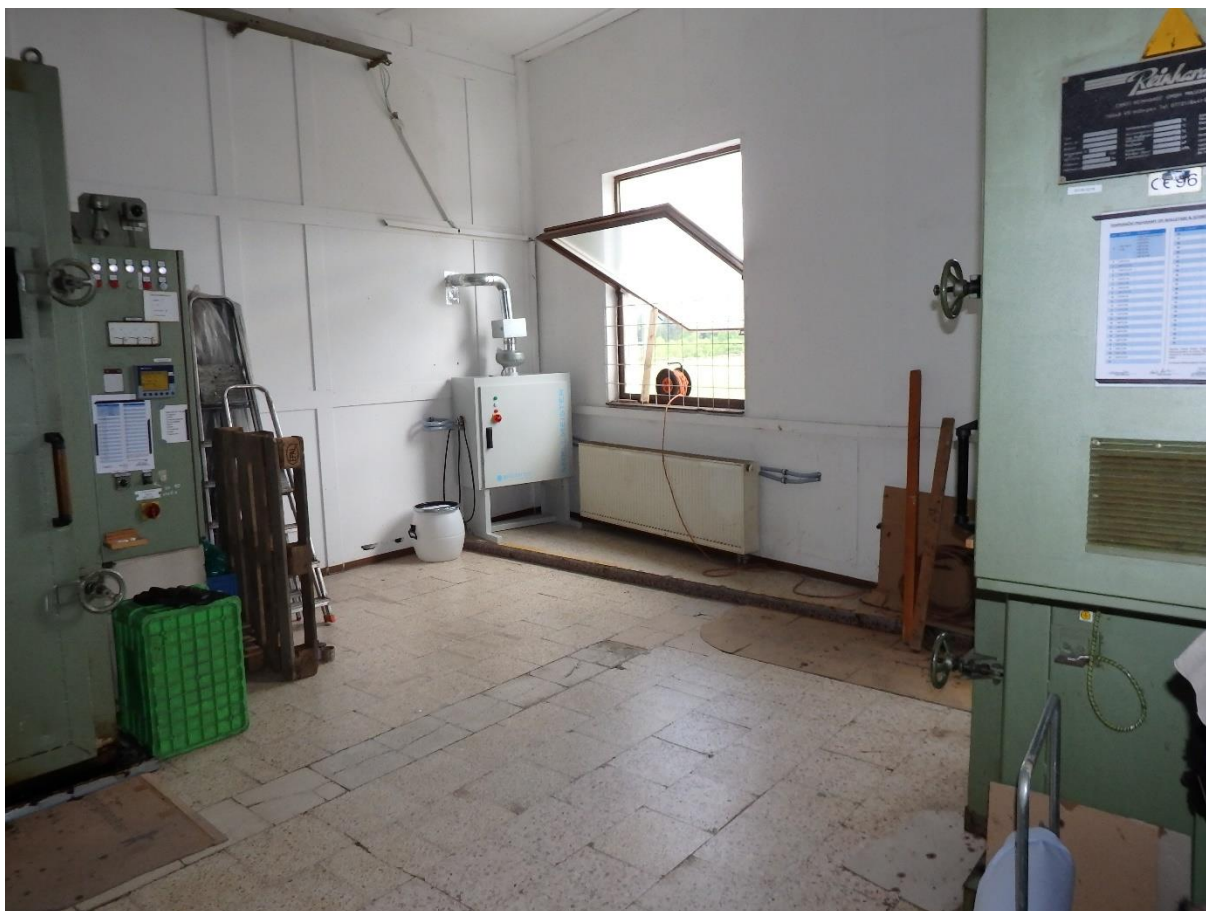
Zařízení Smellmeister® G18 v prostoru výroby s nasáváním čistého vzduchu z vedlejší místnosti
