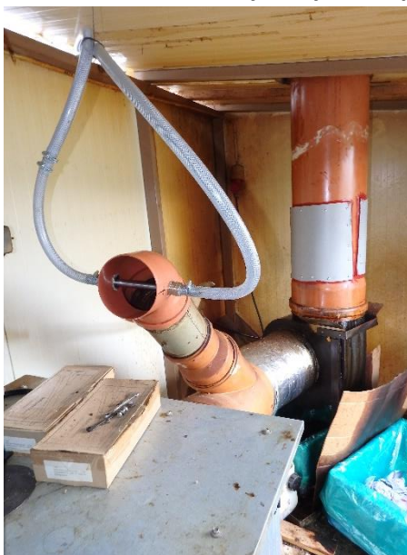
Přívod hadic zakončených tryskou v potrubí
